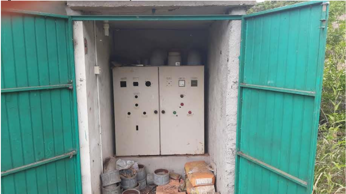
Figura 29: Quadro de comando do Poço 01.
