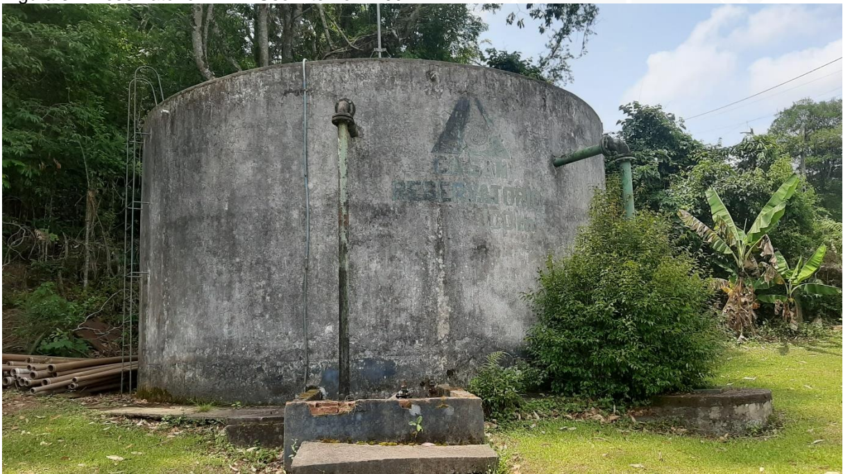
Figura 37: Reservatório ETA – Uso interno – 100 m 3 .
