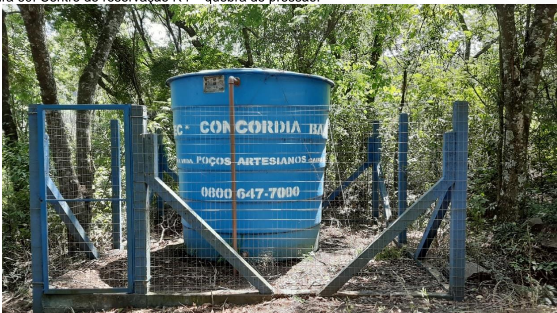
Figura 60: Centro de reservação R4 – quebra de pressão.
