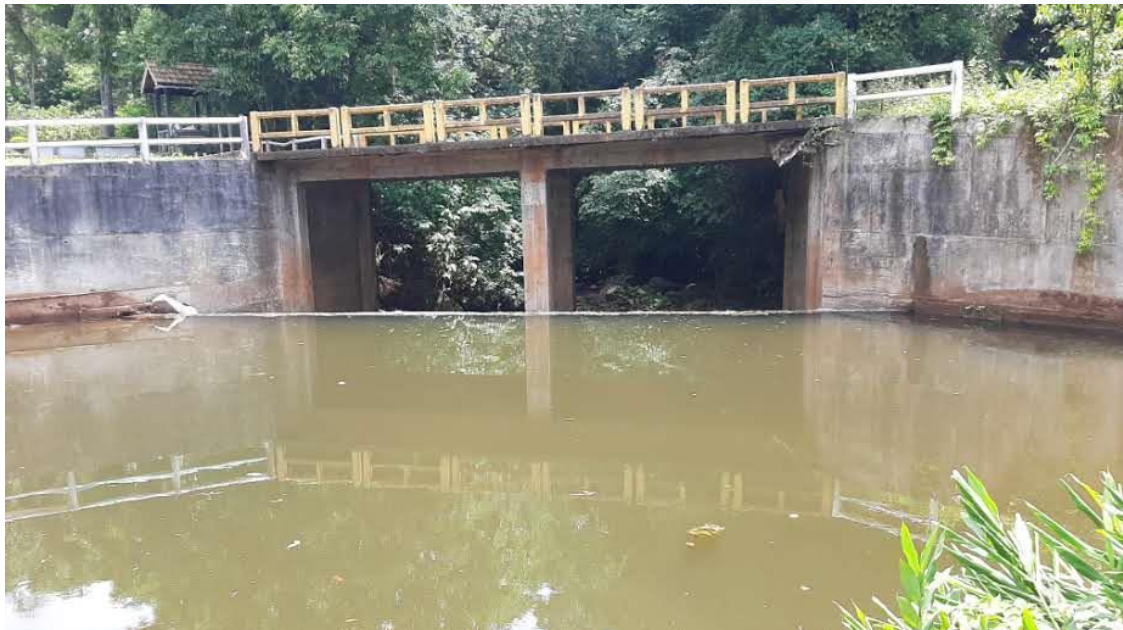
Figura 21: Barragem de nível para captação superficial de água no encontro entre o Arroio dos Veados e um de seus afluentes.
