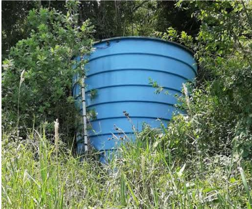
Figura 63: Centro de Reservação R01.
