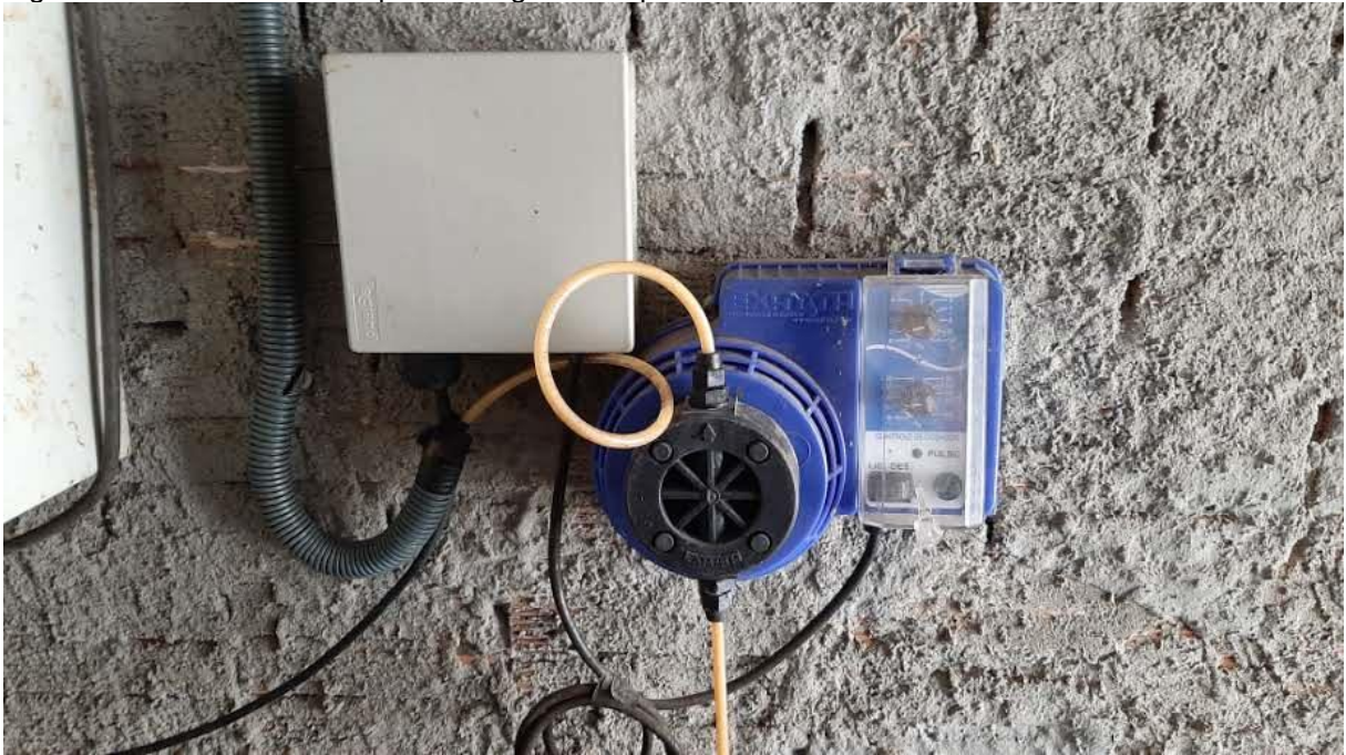
Figura 55: Bomba dosadora para dosagem de hipoclorito de sódio.
