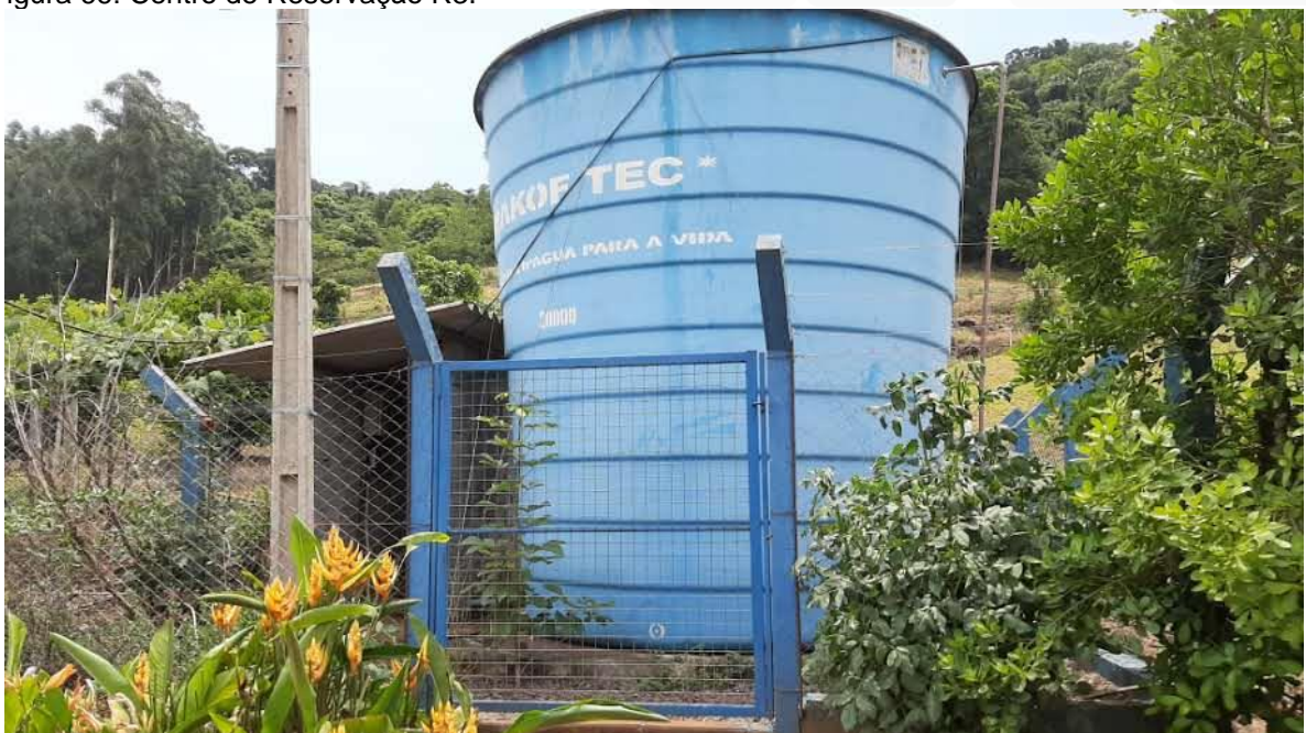
Figura 66: Centro de Reservação R3.
