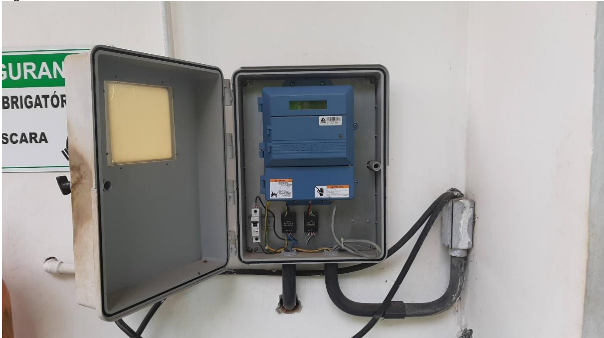
Figura 38: Monitoramento de vazão instantânea e do volume tratado.
