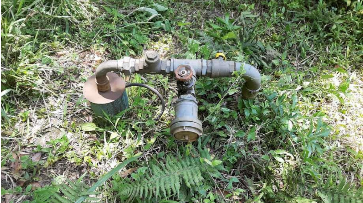
Figura 61 : Poço – Arroio do Meio.
