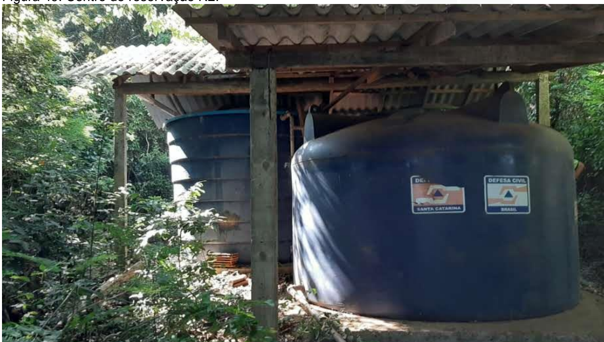
Figura 49: Centro de reservação R2.
