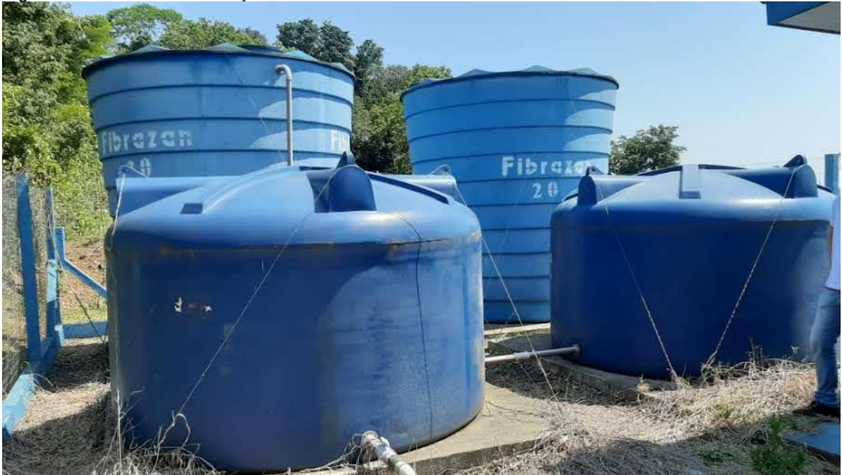
Figura 57: Centro de reservação R2.
