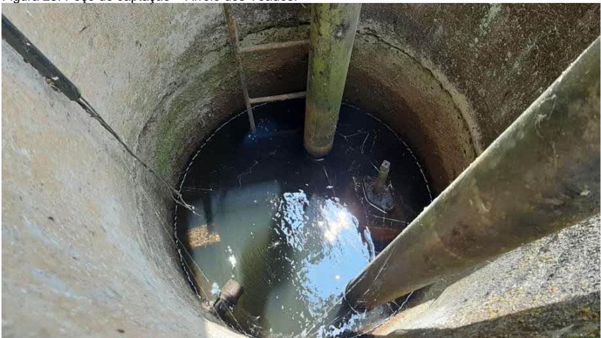
Figura 23: Poço de captação – Arroio dos Veados.
