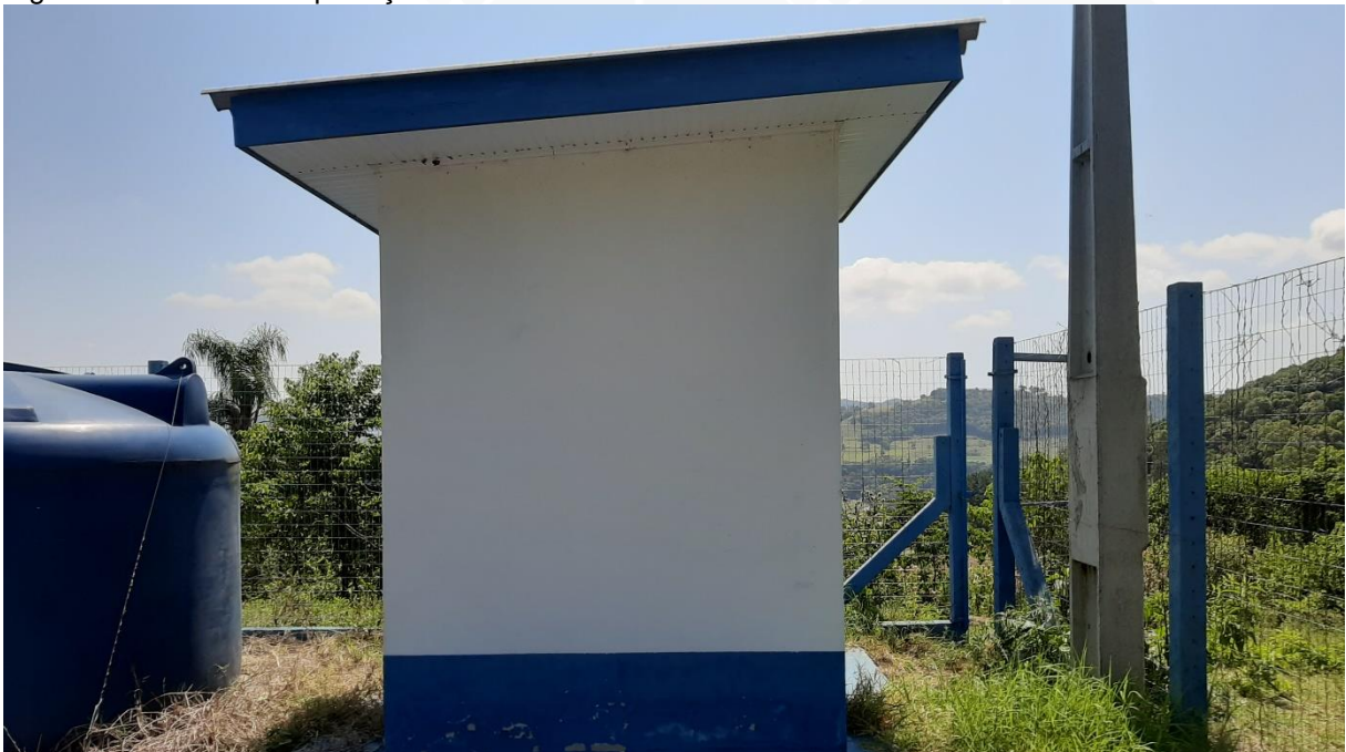
Figura 58: Estrutura de proteção da ERAT 02.
