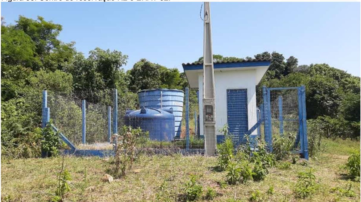
Figura 56: Centro de reservação R2 e ERAT 02.
