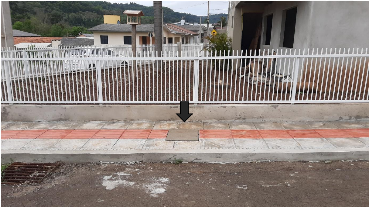
Figura 72: Tampa de acesso à fossa comunitária localizada sob passeio público.
