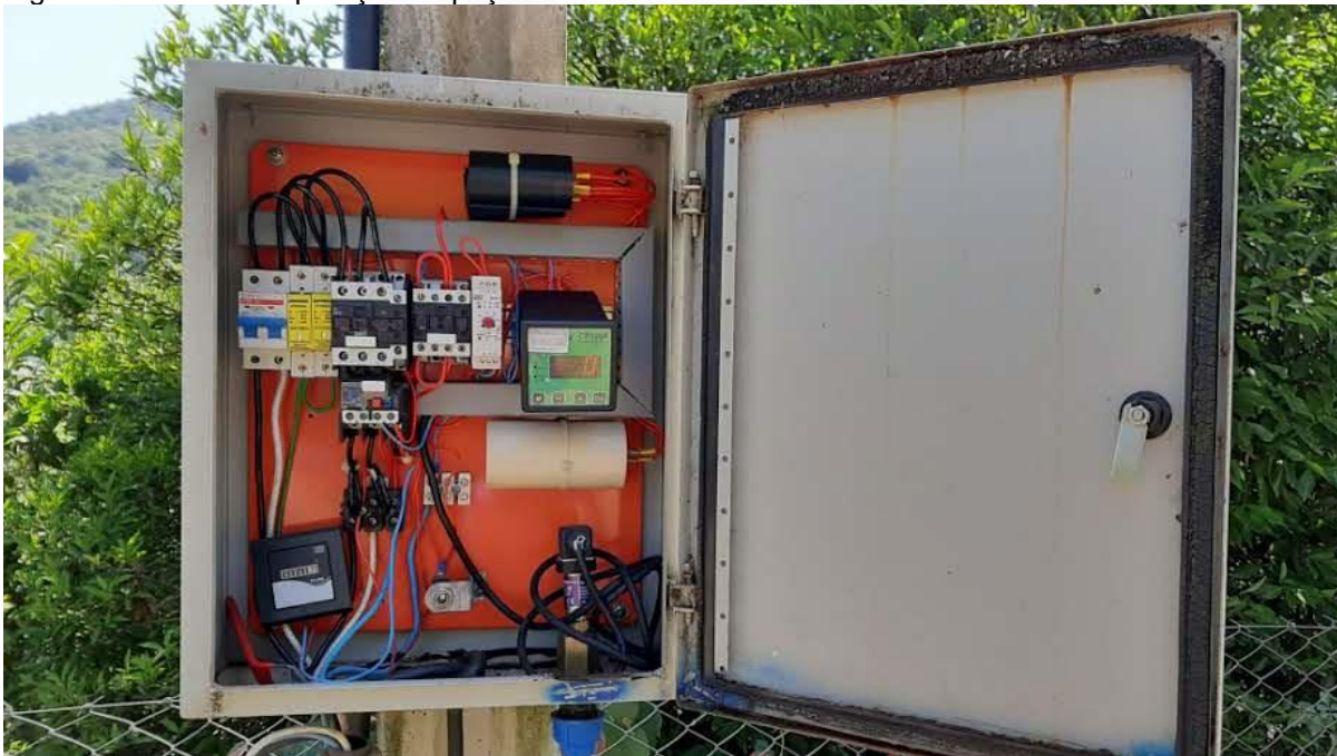
Figura 52: Painel de operação do poço.
