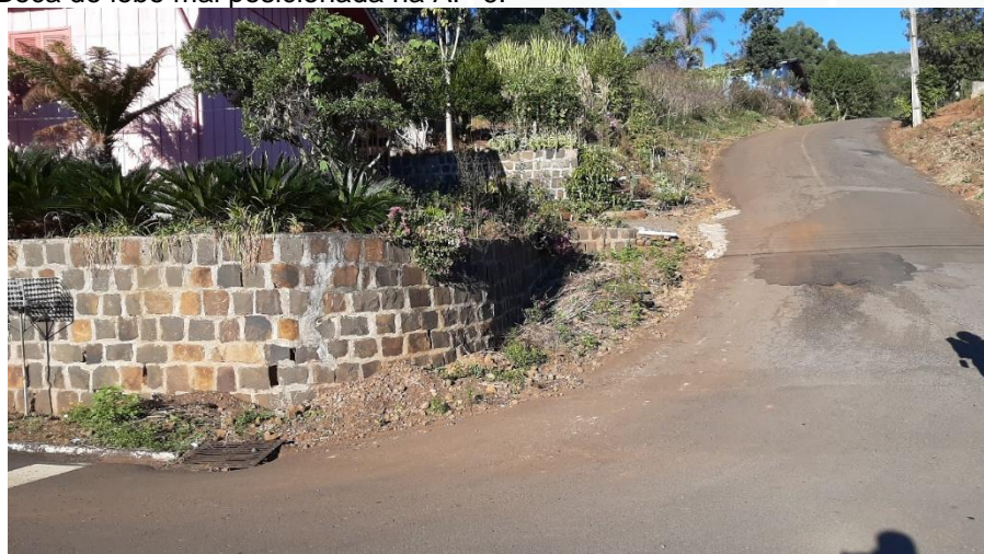
Figura 136: Boca de lobo mal posicionada na AP-6.
