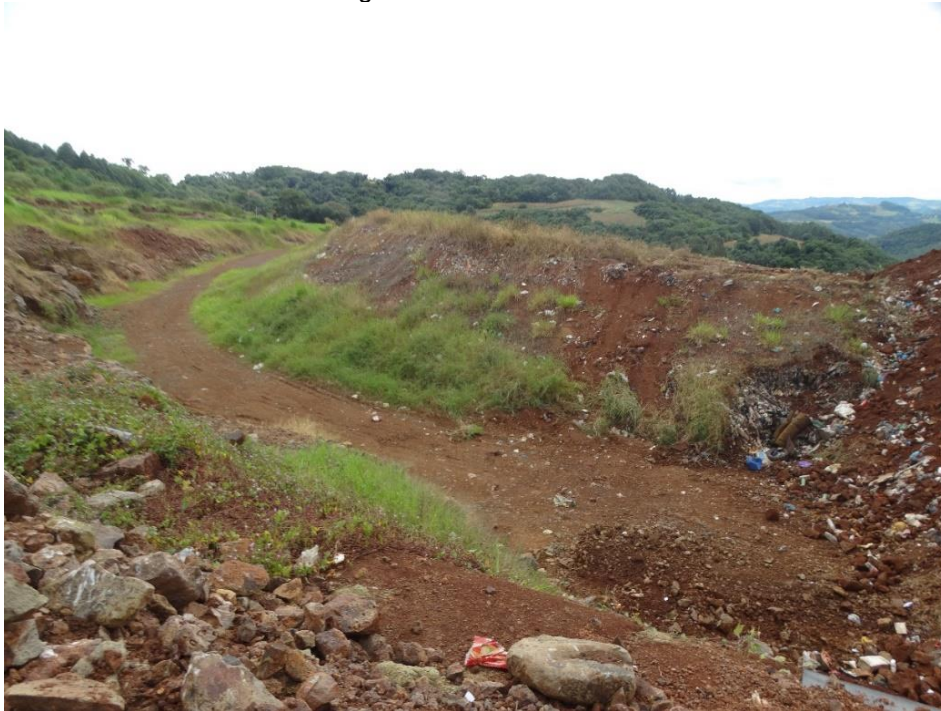
Figura 93: Ausência de sistema de drenagem.
