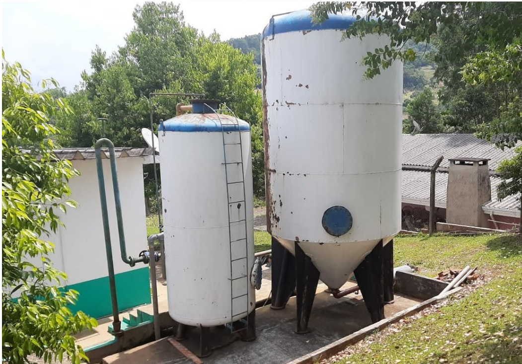
Figura 32: ETA – Floccodecantador e filtro.
