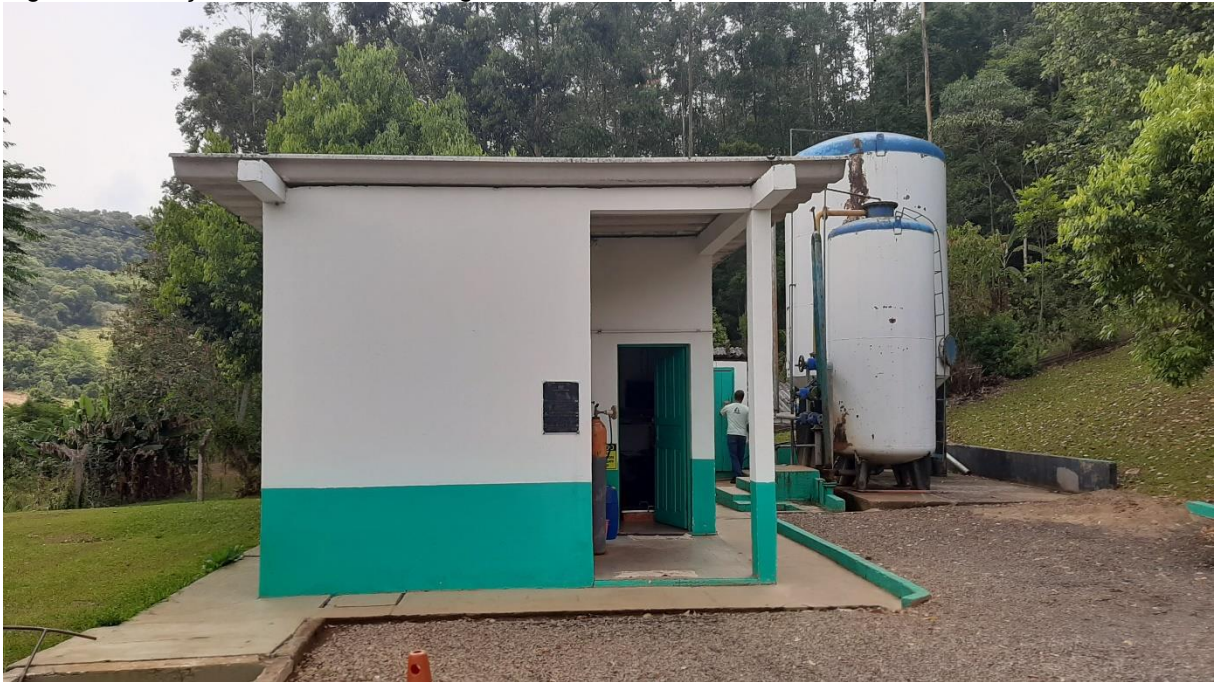
Figura 33: Estação de tratamento de água metálica compacta e casa de química.
