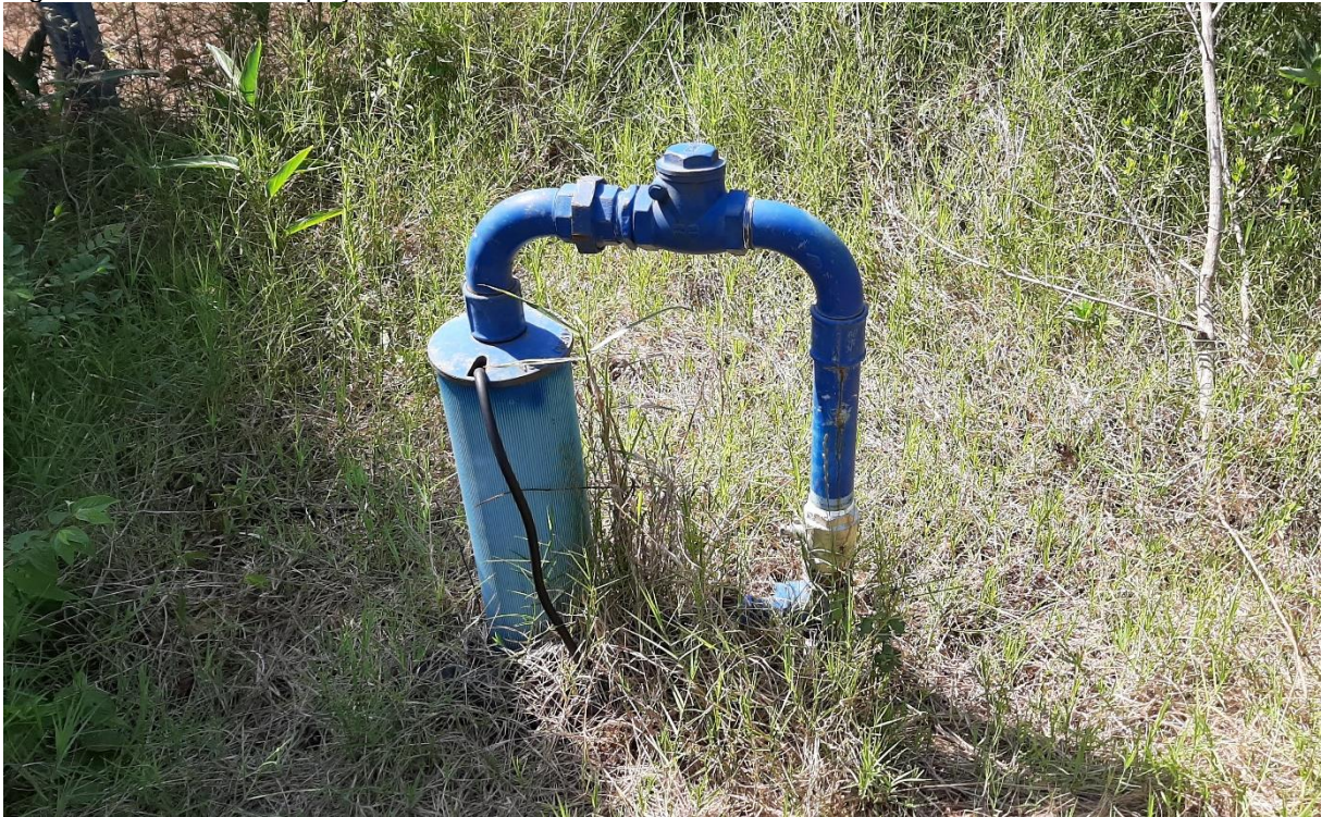
Figura 50: Cavalete do poço.
