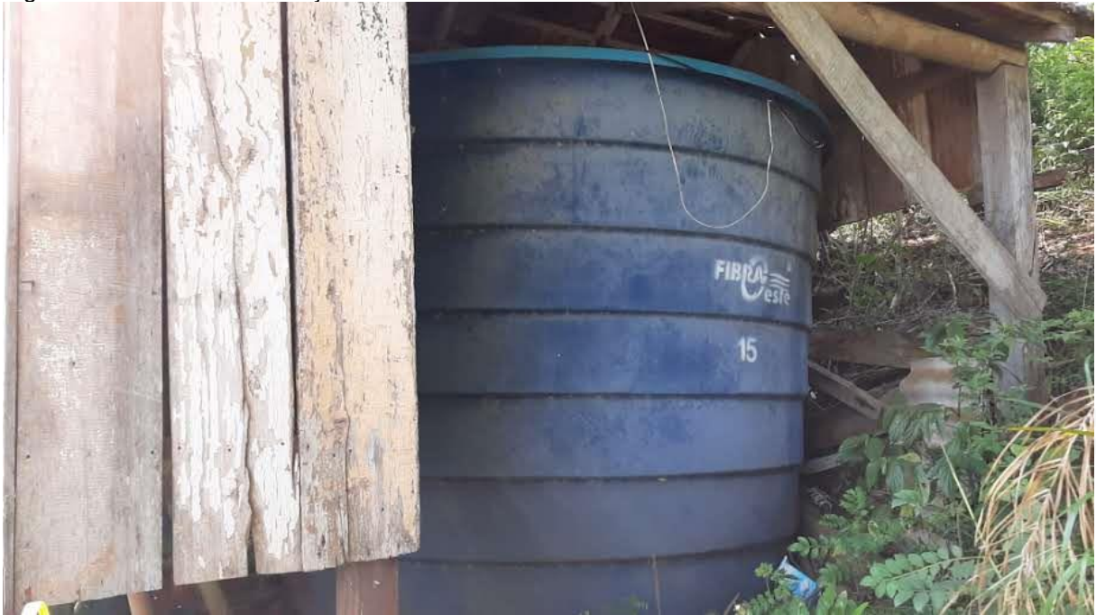
Figura 47: Centro de reservação R01 – PRFV 15m 3 .
