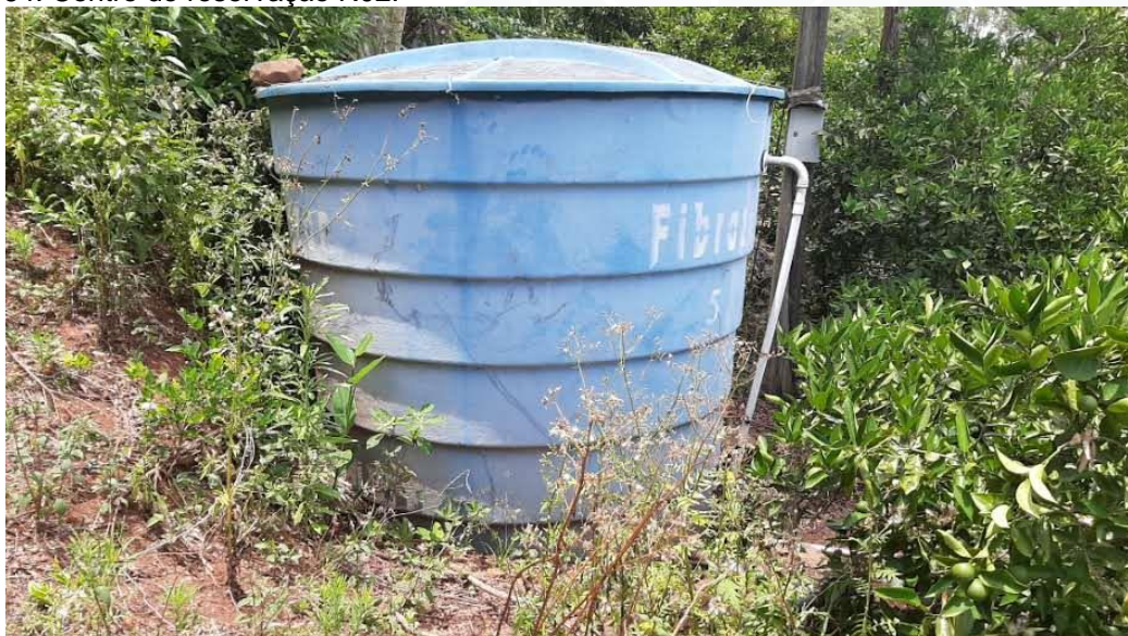
Figura 64: Centro de reservação R02.
