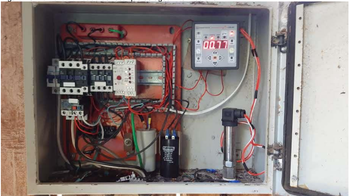
Figura 48: Painel da unidade de recalque de água intermediária.
