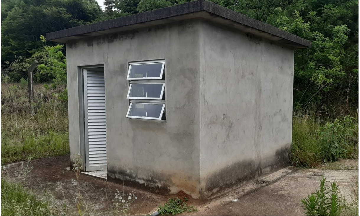
Figura 27: Estrutura de alvenaria para proteção cavalete poço sem pintura.
