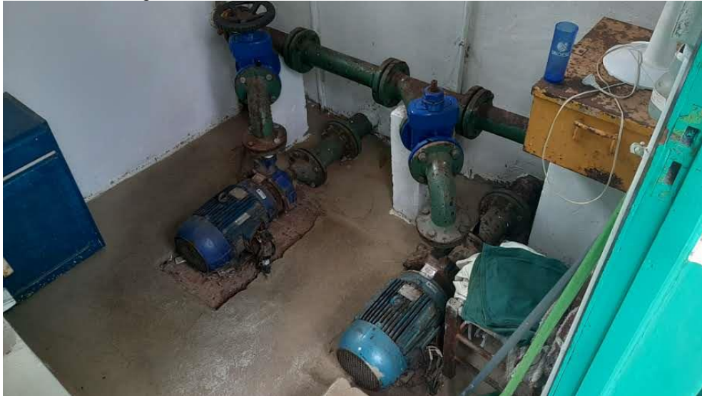
Figura 42: Elevatória de água tratada – 15 cv.
